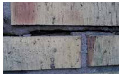
Korroderande armering spränger och trycker ut murverksfogen.
