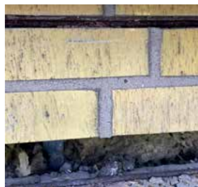
Korroderande armering spränger och trycker ut murverksfogen.
